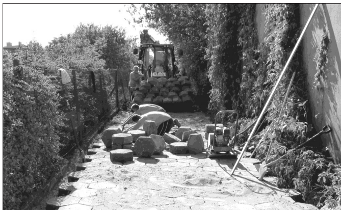
Trwają prace związane z utwardzeniem ulicy Dobrej. Ułożona zostanie kostka betonowa. Ulica będzie utwardzona na odcinku 230 mb. Materiały do utwardzenia nawierzchni zostały pozyskane dzięki dobrej współpracy ze Starostwa Powiatowego w Pabianicach w związku z remontem ul. Nowotki w Ksawerowie, część trylinki przekazał ksiądz proboszcz St. Bracha
